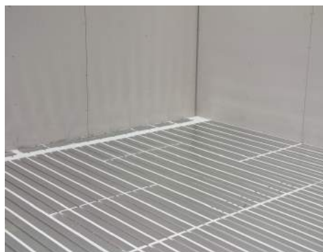
12. Installationen är klar.
