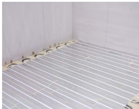
26. Installationen är klar.
