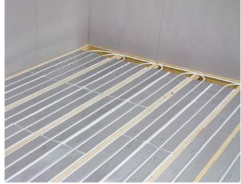
12. Installationen är klar.
